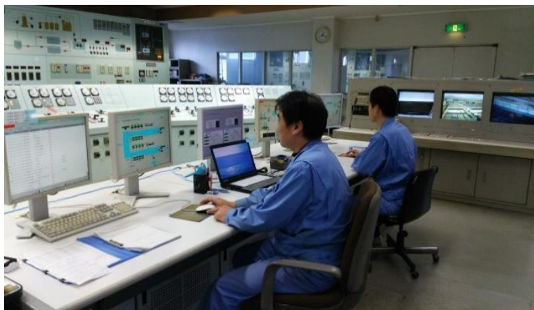
中央監視室の運転状況
