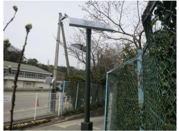
ソーラー街路灯(片浦小学校)
