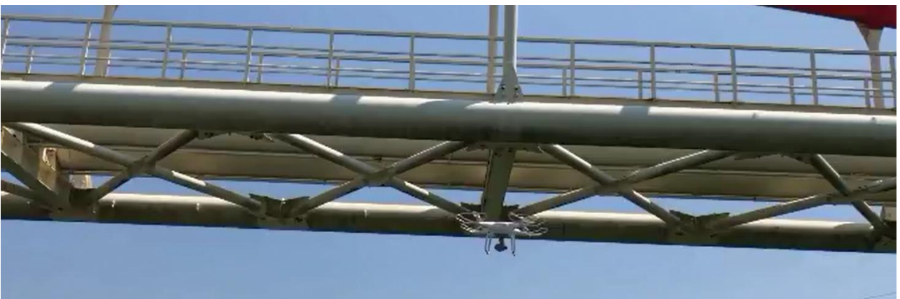
ドローンによる水管橋の点検の様子 (オリジナル設計株式会社提供)
