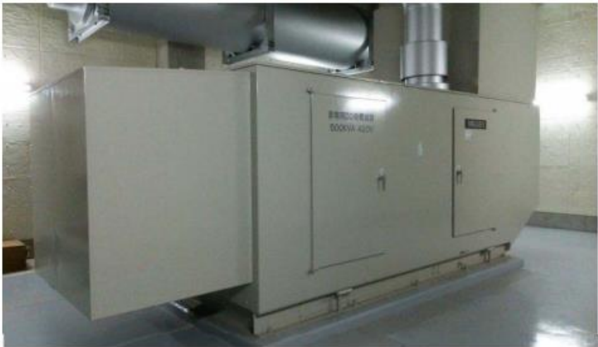
非常用自家用発電設備の設置例(第二水源地)
