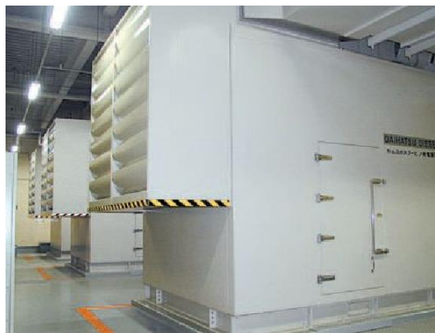
非常用自家用発電設備の設置例 (ダイハツディーゼル株式会社ホームページより)
