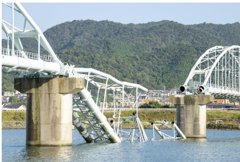
崩落した六十谷(むそた)水管橋
