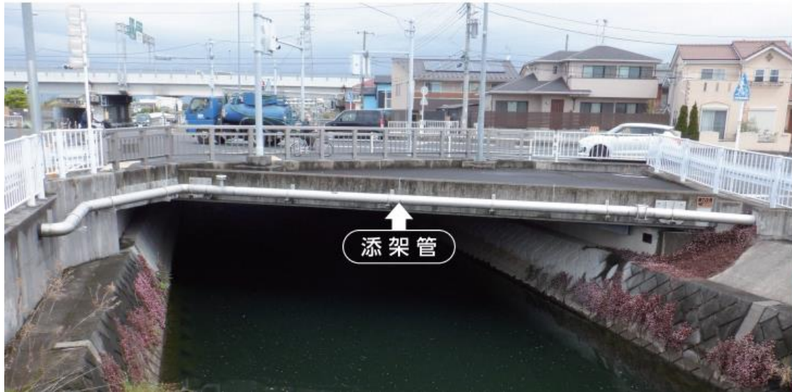
③河川を横断する管路(添架管)
