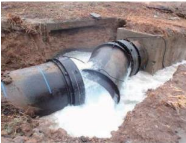
継手が離脱した伸縮可とう管
