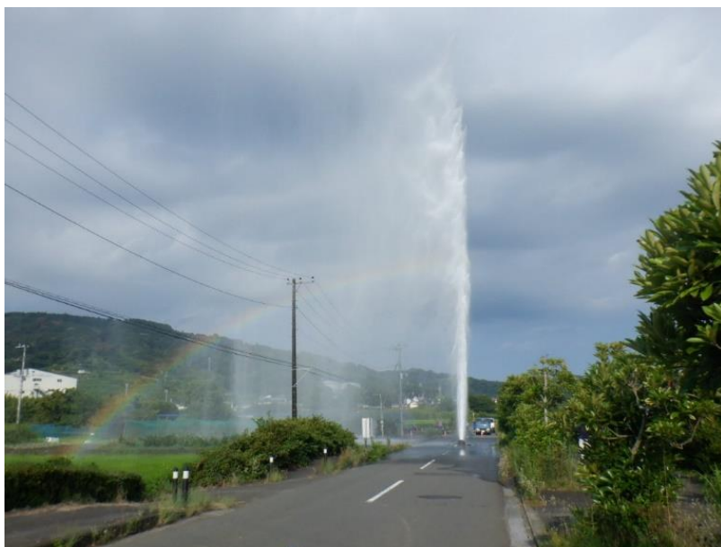
空気弁からの漏水(令和3年7月 上曽我地内)
