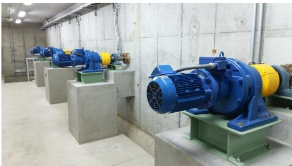
インバータ制御対応モータ(高田浄水場沈でん設備の攪拌機)
